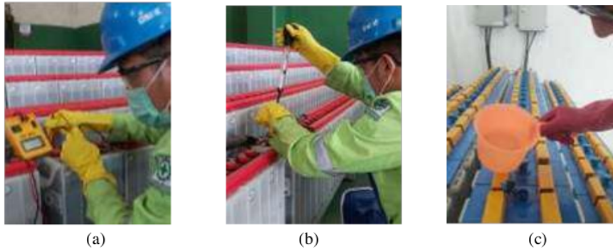
Gambar 3.5 (a) Pengukuran Tegangan Baterai, (b) Pengukuran Berat Jenis, (c) Pengisian Air Elektrolit
