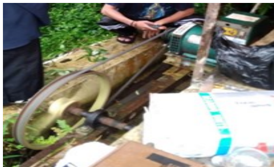
Gambar 4. Implementasi pada Generator B
