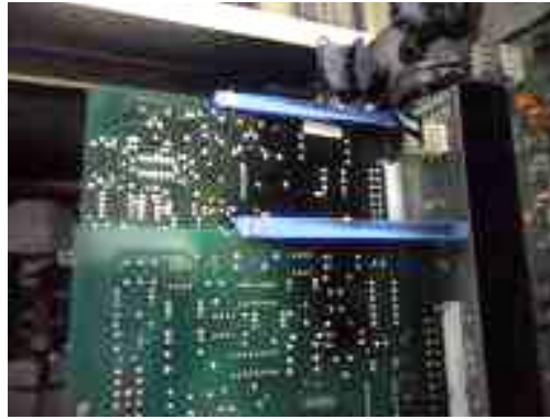
Gambar 6. Hasil inspeksi visual modul inverter
