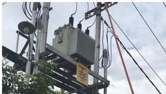
Gambar 2. Transformator distribusi 200 kVA di Ronggowarsito
