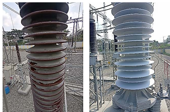
Gambar 9. Foto isolator keramik dan karet silikon pada kondisi setelah pemeliharaan
