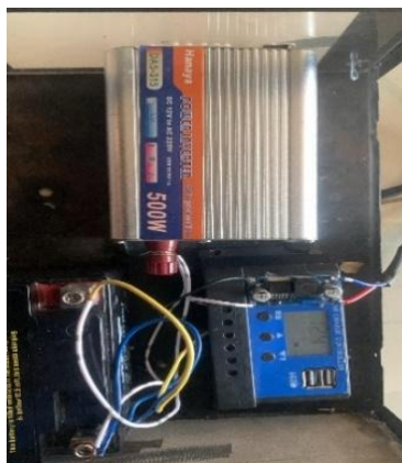
Gambar 11. Perakitan Sistem Baterai
