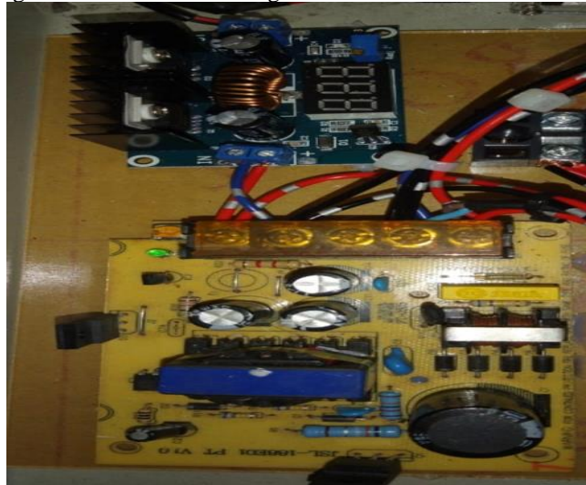
Gambar 5 Pemasangan Catu Daya
