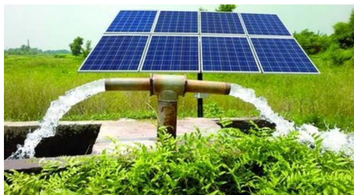
Gambar 6. Pemanfaatan solar cell pada mesin pompa listrik sebagai penyalur air (Sumber : Desapintar, 2021).
